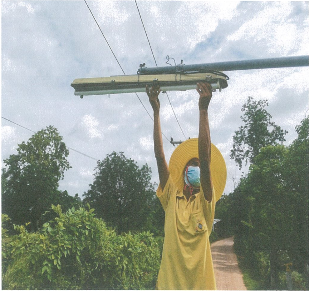
ภาพถ่ายการซ่อมแซมไฟฟ้าสาธารณะ บ้านคู หมู่ที่ ๑
